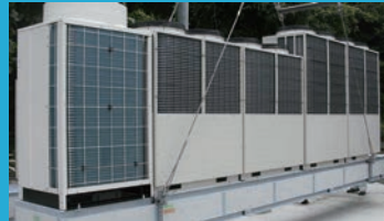
屋外機ユニット
