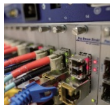
サーバーおよび 通信機器
