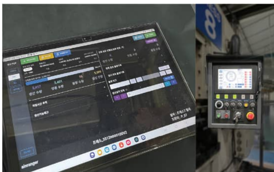
5 MES（製造実行システム）・ PMS（電力監視システム）統合運用 生産効率を向上し、工場運営を最適化
