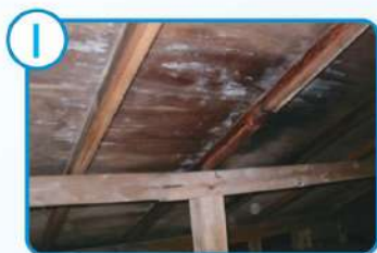
1 結露を放置したことによって 野地板に発生したカビ。
