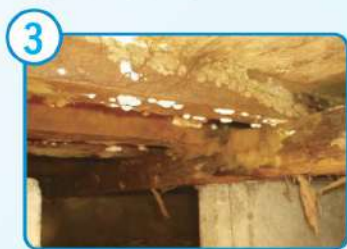
3 床下に大量に発生したカビと 腐朽。周囲はシロアリに食害 されています。
